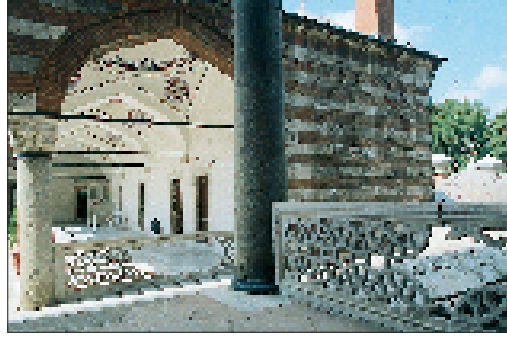
Resim 11. Zal Mahmud Paşa Camii. Yoğun araç trafiğinden dolayı külliye'nin batı duvarının durumu. Foto: Aras Neftçi
