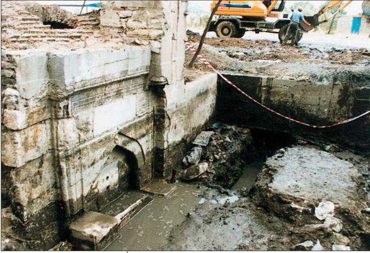
Salih Sultan Çeşmesi'nin toprak ve çamur altından çıkarılan ön cephesinin durumu.
