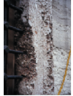
Resim-2; Siyavuş Paşa Türbesi. Pudingten yapılmış sövelerde oluşan ayrışmalar
