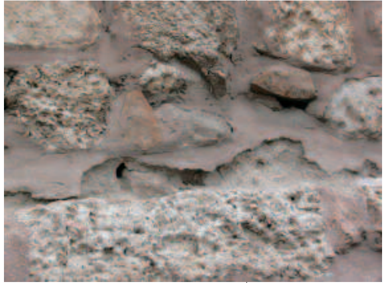
Resim 2. Çimento harçlı horasan benzeri harçlarla yapılan onarımlarda görülen bozulmalar
